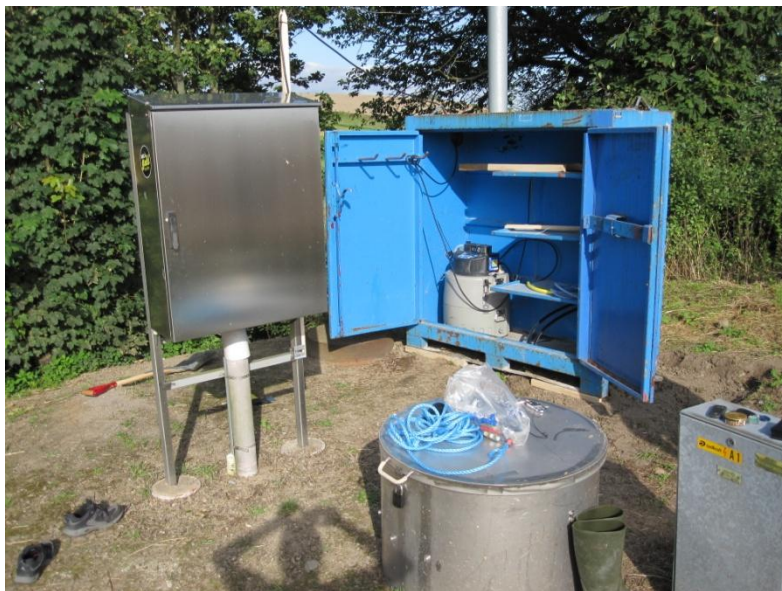
Figur 5: Provtagaren på de automatiserade mätstationerna står i en mindre container. Här stationen vid Kullåkra.
