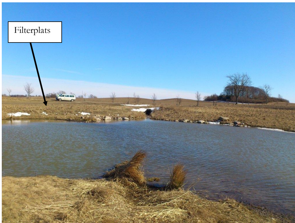
Figur 26: Platsen för kalkfiltrets placering i riktning österut söderut, innan installation. Till höger om bilen syns våtmarkens utlopp (Tullstorpsån), en öppen bäckfåra som leder in i en kulvert under vägen.
